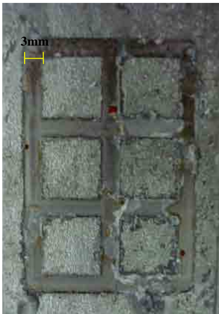
Fotografia 47 - Corpo-de-prova 13 - área exposta 660mm 2 com a presença de pequenos pontos oxidação
